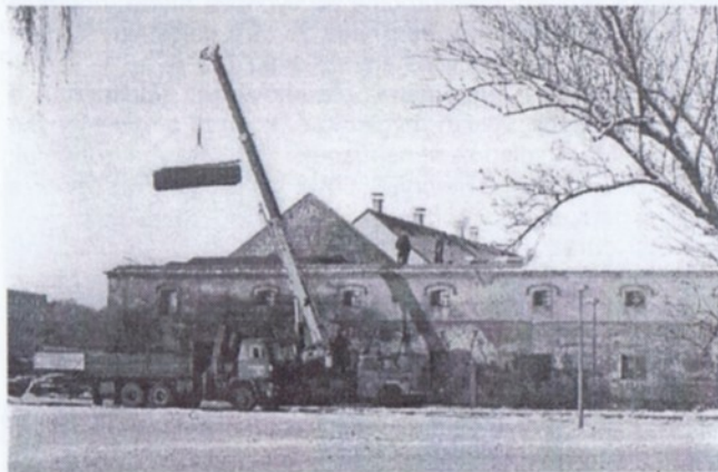
Dělníci firmy RISL při rekonstrukci východního křídla zámeckého dvora. Snímek je z 12. ledna t.r.
