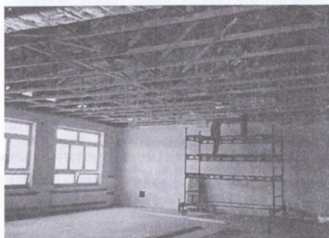
Pracuje se na izolacích ve st. opě audiovizuálního sálu foto 20.5.2002 – A. Křížková
